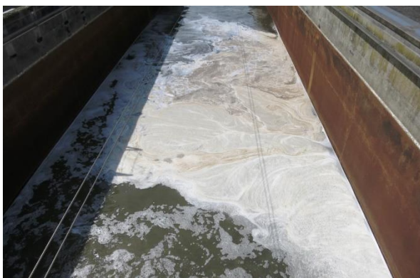
Abb. 5: Löschwasserstapelung in Vorklärung
